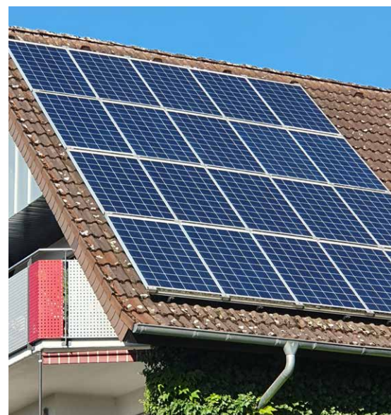
Dach mit Photovoltaik
